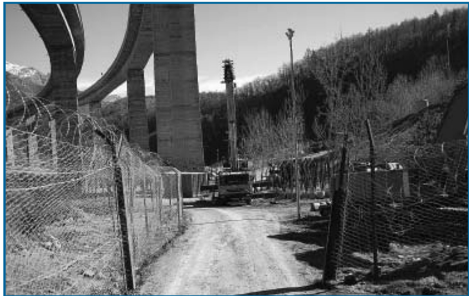
Il cantiere per la costruzione del tunnel del treno ad alta velocità ferroviaria
