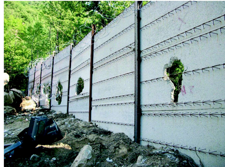
DANNEGGIAMENTI Lanci di pietre e rottura dei pannelli di calcestruzzo al cantiere di Chiomonte
