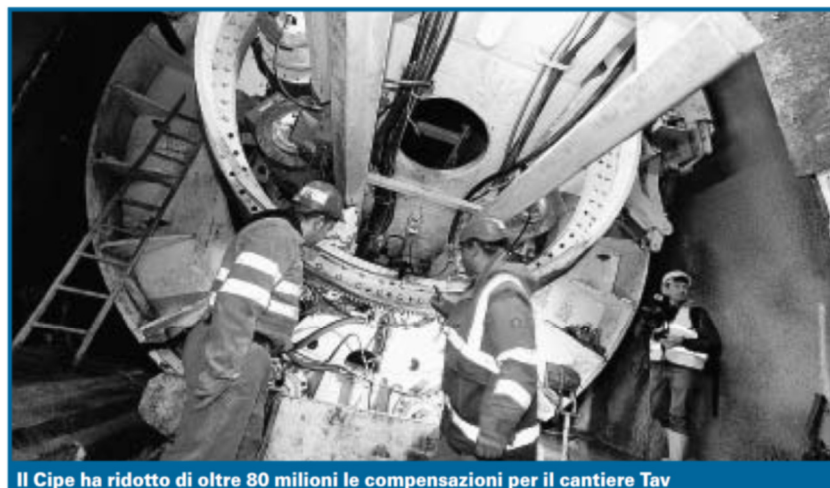
Il Cipe ha ridotto di oltre 80 milioni le compensazioni per il cantiere Tav
