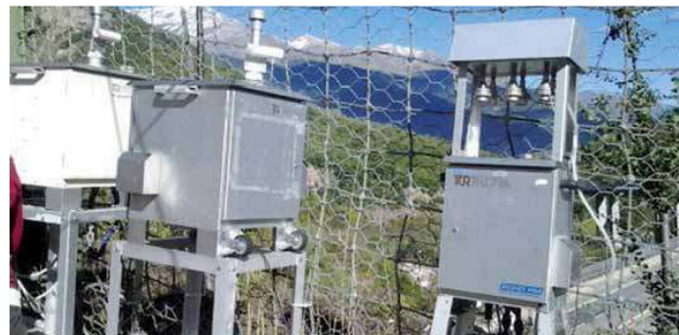
Alcune centraline per il monitoraggio ambientale all'interno e all'esterno dell'area di cantiere
