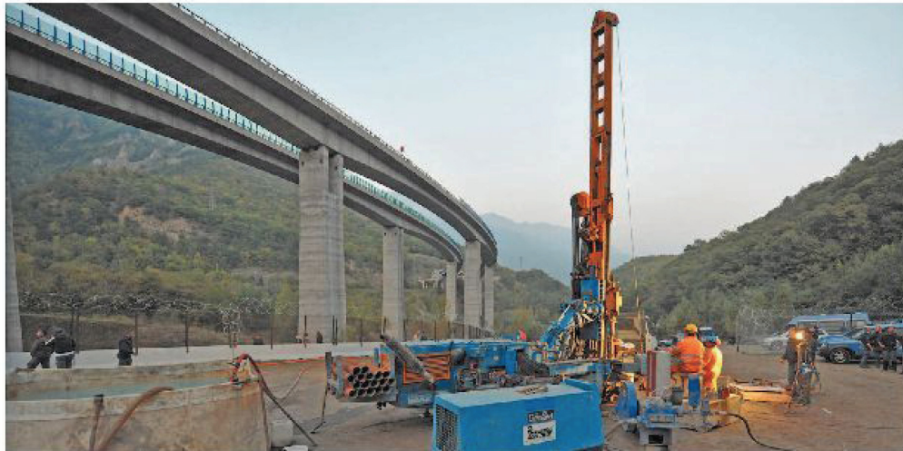
I lavori per la realizzazione della Tav al cantiere di Chiomonte in Val di Susa. Per l'ambasciatore Le Roy la «Torino-Lione è un'opera strategica per l'Europa»
